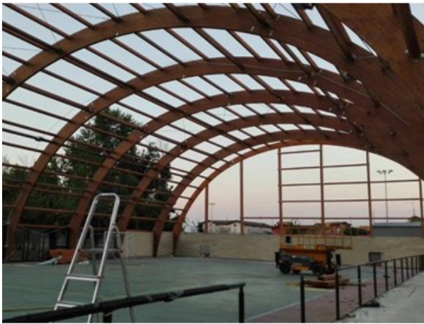
Aggiunta di due archi lamellari di testata e rinforzo della struttura in legno con reticolo di arcarecci in legno
